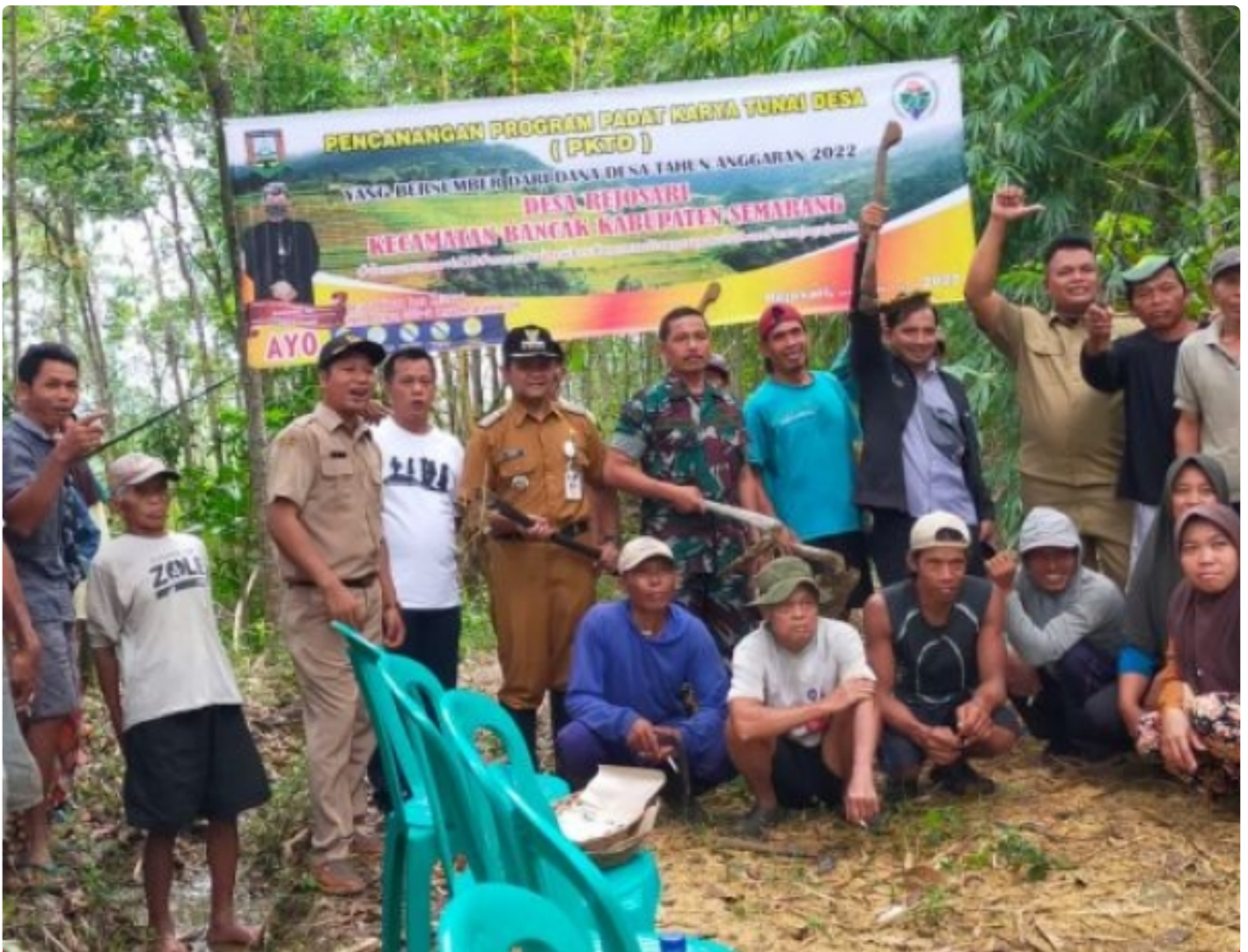
Pelda S. Amin bersama Forkopicam Bancak hadir kegiatan Padat Karya Tunai Desa berupa pembuatan saluran air.
